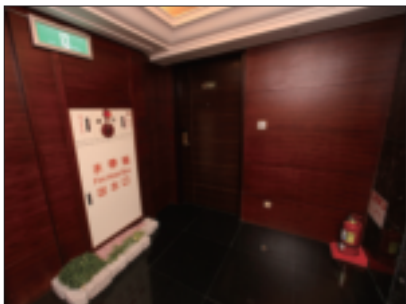
消防安檢設備是三安旅館的評核要項之一。
