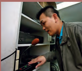
緊急廣播設備是市府消防安檢的項目之一。
