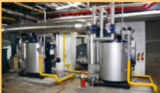
從汰換冰水主機、定期保養相關配備等措施，可看出三德大飯店在節電上的用心。（劉佳雯攝）
