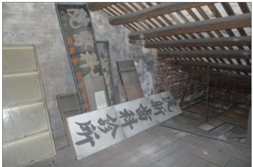
改造前的「瓦豆·光田」閒置了大約八年，當時地板結構不穩且橫樑斷裂，屋況頹圯。
