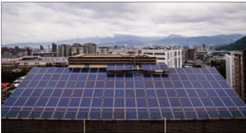
大龍峒公營住宅符合綠建築標準，屋頂設置太陽能發電系統，供應公共區域照明用電。
