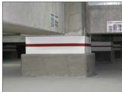
設於地下1樓的隔震層，可將7級強震減為4級。
